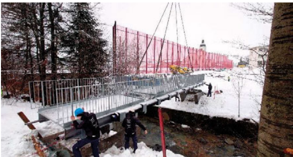
Die neue Wasserleitung entlang der Brücke
